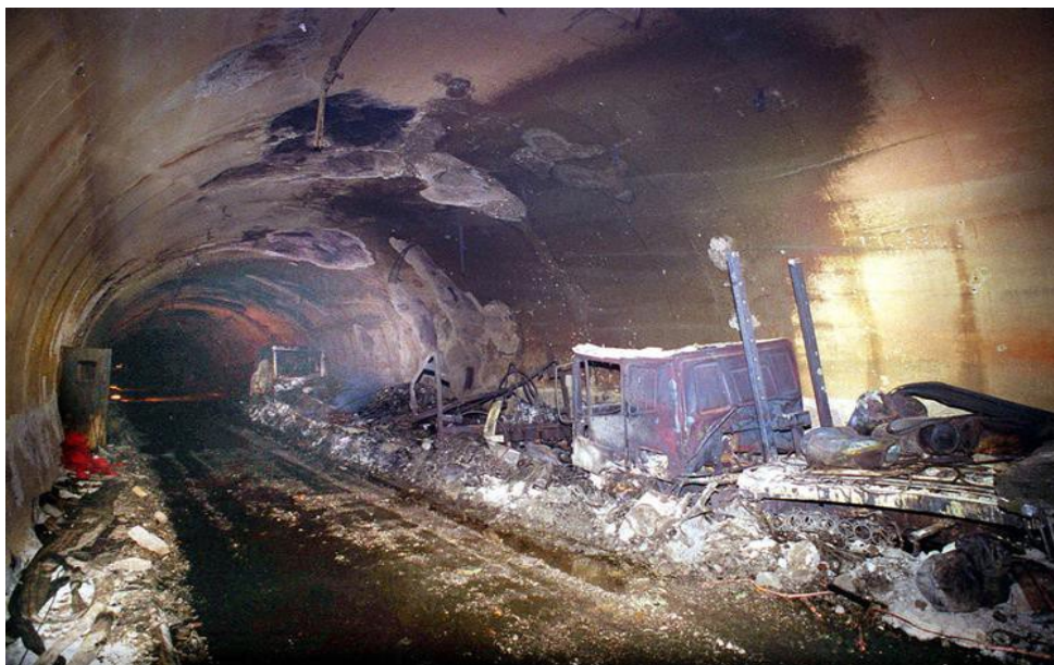
Фигура 1. Последствия върху облицовката след пожара в тунел „Мон Блан
